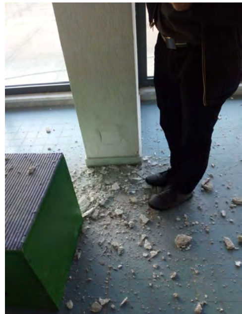
Residui di intonaco trave di copertura carbonatata per presenza di ferri distanziatori ossidati
