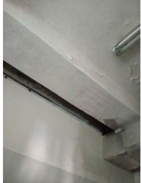
Trave spogliatoio con ripristini mal eseguiti Sono evidenti le lesioni di espulsioni
