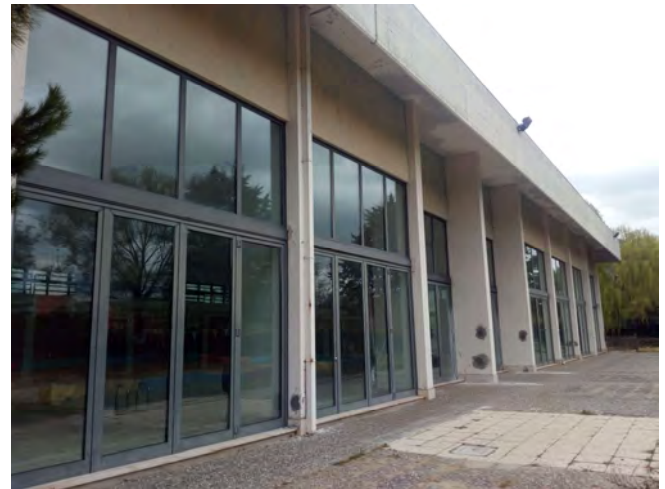
Solette e Velette di copertura in c.a. Piccoli spessori delle velette e conseguente ossidazione delle armature per mancanza di copriferro
