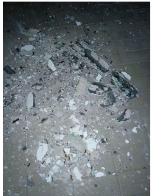
Residui di demolizione di una trave " mal riparata" Evidente passivazione dell'acciaio e malta tissotropica espulsa
