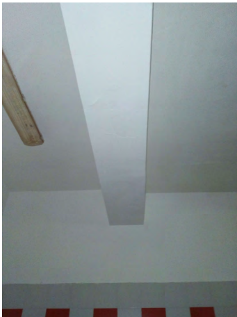
Trave spogliatoio con lavori di ripristino mal eseguiti Sono evidenti le lesioni delle espulsioni
