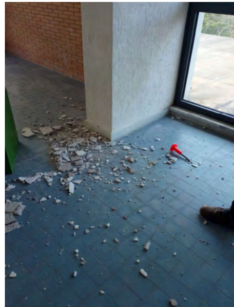
Residui intonaco trave di copertura carbonatata per presenza di ferri distanziatori ossidati
