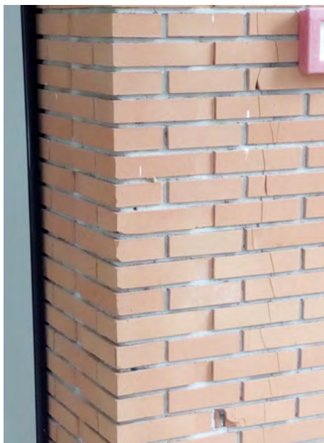
Lesione sul rivestimento di un pilastro in c.a.
