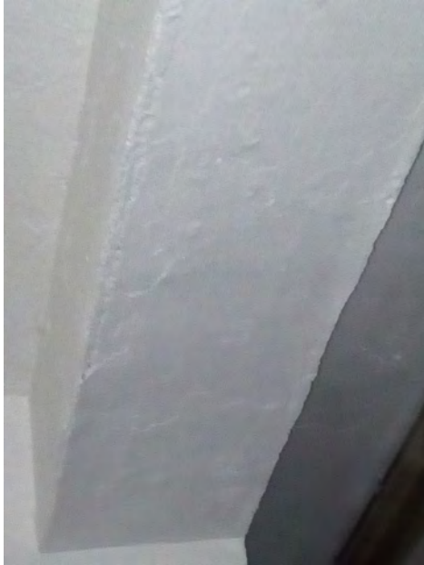
Trave spogliatoio con ripristini mal eseguiti Sono evidenti le lesioni di espulsioni
