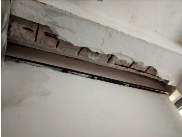
Trave spogliatoio con riparazione mal eseguita e ossidazione del ferro di armatura e carbonatazione del c.a.
