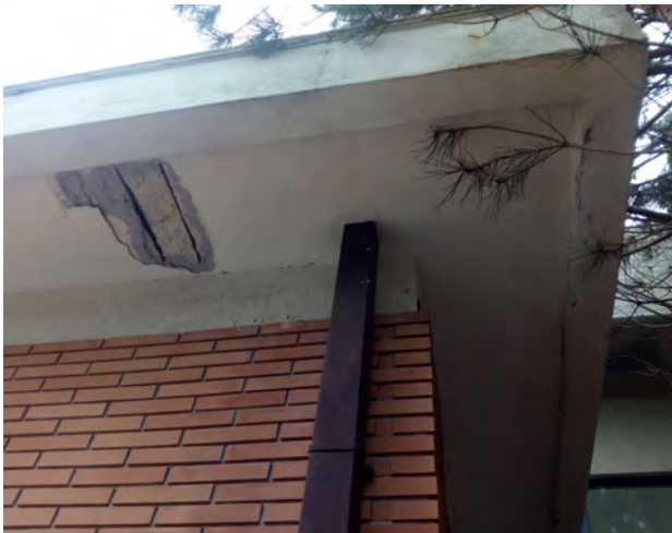
Condizione attuale delle solette a sbalzo in c.a. Mancanza di copriferro e carbonatazione del c.a.
